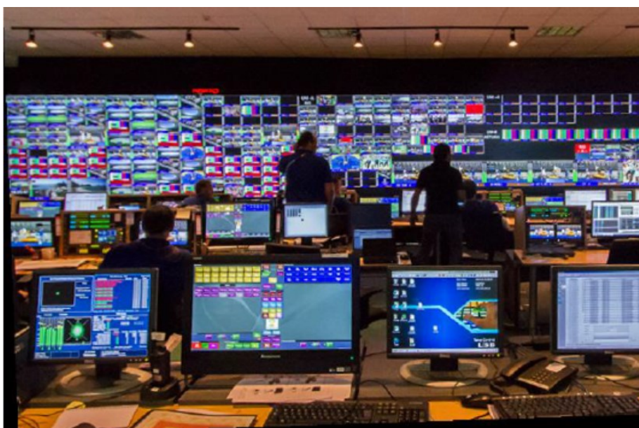
شکل ۴- اتاق کنترل مرکزی یا (MCR) در بخش چند وجهی. قبل دریافت، کنترل و توزیع سیگنال‌ها است.
